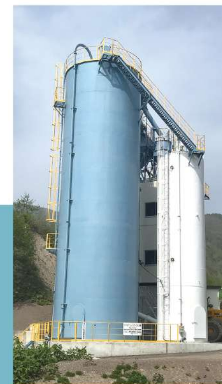
セメント保管サイロ
